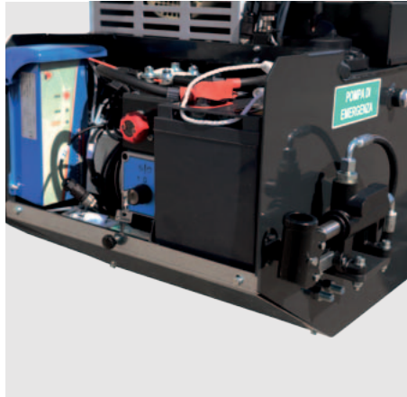
Bomba manual de emergencia y compartimento que aloja la batería y el control de la electrobomba de emergencia y la conexión de la batería.
